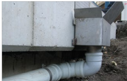
Üblicher FÜK-Einlauf aus Edelstahl (Korrosionsproblem!)
